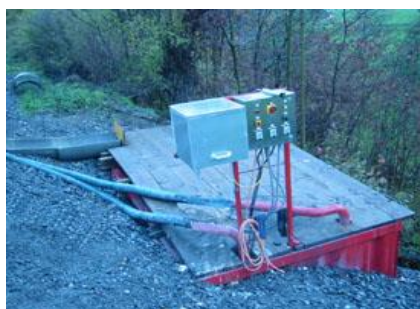
Esterna vasca di sedimentazione laterale, contenuto 200'000 l
