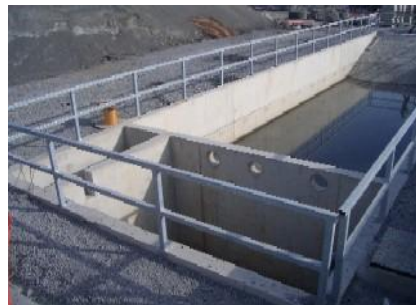
Au premier plan: compartiment pompes avec surverse et un bassin séparé d'eau propre pour le portique d'arrosage des chargements.
