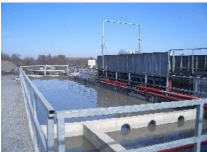
Bassin de recyclage latéral en béton (réalisé par l'exploitant) Longueur 21m - Largeur 5m
