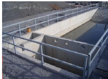
Im Vordergrund die Pumpenkammer mit Überlauf und das Becken mit Frisch-Wasser für die Ladegutbefeuchtung.
