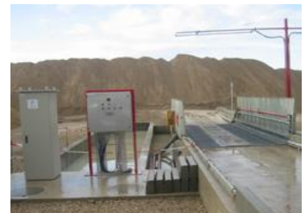
Seitliches Absetzbecken, wird ausgepumpt mit Spezialtauchpumpe von FRUTIGER.
