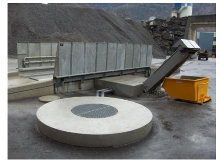
Pumpenschacht für die 4 Pumpen mit einer maximalen Leistung von 7'200 l/min
